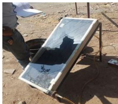
Fig 3 Actual setup of solar water heater
